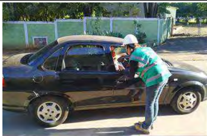
Foto 2 – Equipe de comunicação orienta motorista sobre bloqueio em decorrência da atividade de desmonte de rocha. (20/12/19)
