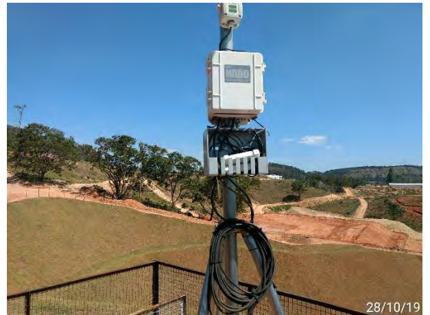
Equipamento registrador de dados que envia os dados automaticamente.
