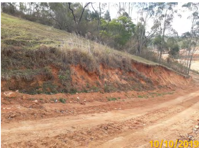
Foto 01: Vista do processo erosivo na estrada. Nota-se a formação de sulcos erosivos formados pela concentração do escoamento.
