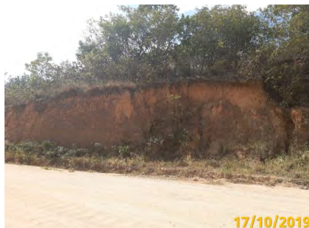
Foto 02: Risco de deslocamento do maciço rochoso/terroso.
