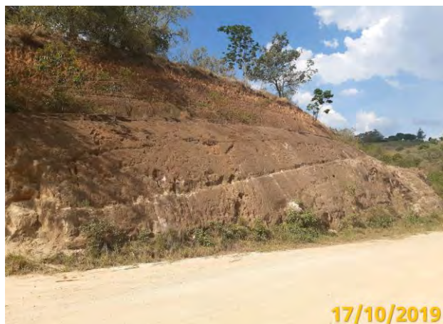
Foto 01: Área de passivo ambiental.
