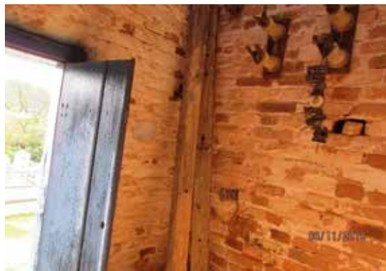
Cabine de energia - Int. Vista 02
