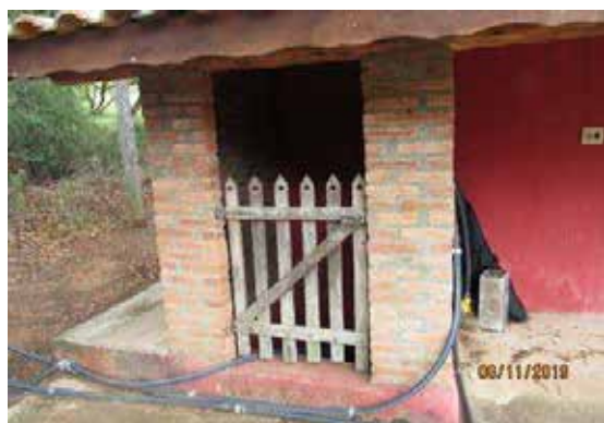
Vista de acesso ao PV 02
