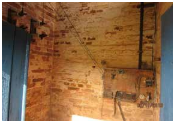
Cabine de energia - Int. Vista 01
