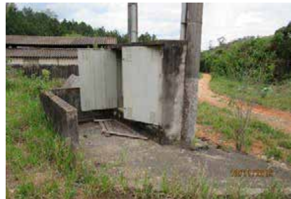
Vista do Quadro de Entreda
