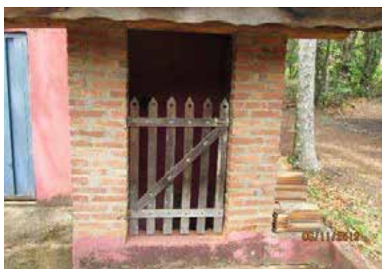
Vista de acesso ao PV 01
