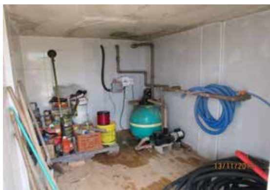
Casa de máquinas
