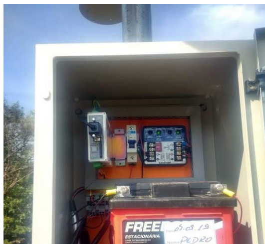
Foto 4 – Detalhe do painel do Posto Hidrométrico (05/09/19).
