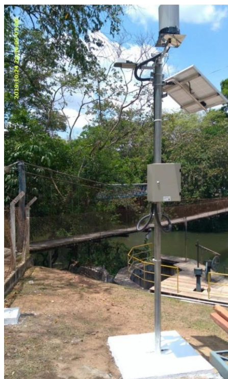
Foto 33 - Estação Telemétrica Limpa (perto)
