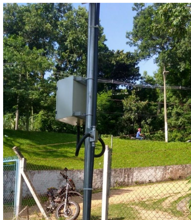
Foto 21 - Estação Telemétrica Limpa (perto)
