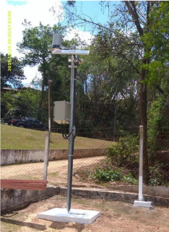
Foto 32 - Estação telemétrica Limpa (longe)
