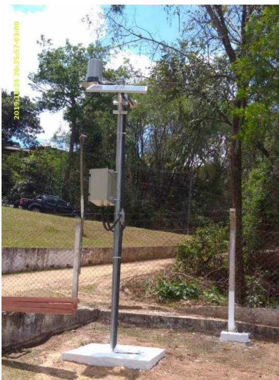
Foto 32 - Estação telemétrica Limpa (longe)
