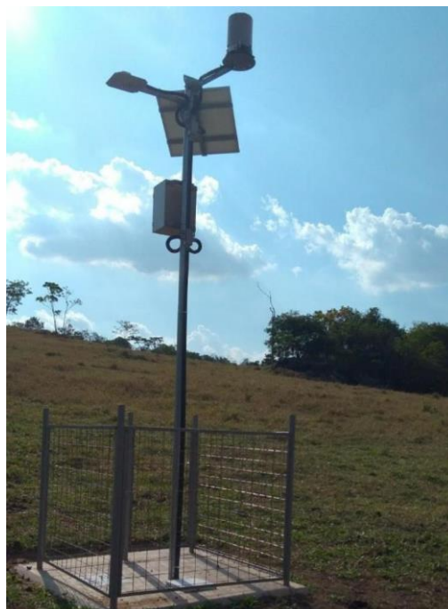
Foto 8 - Estação Telemétrica Limpa (perto)
