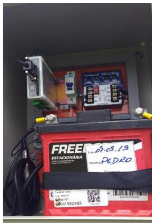
Foto 10 - Estação Telemétrica Limpa (perto)
