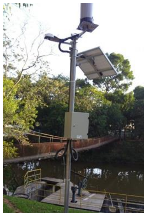
Foto 21 - Estação Telemétrica Limpa (perto)
