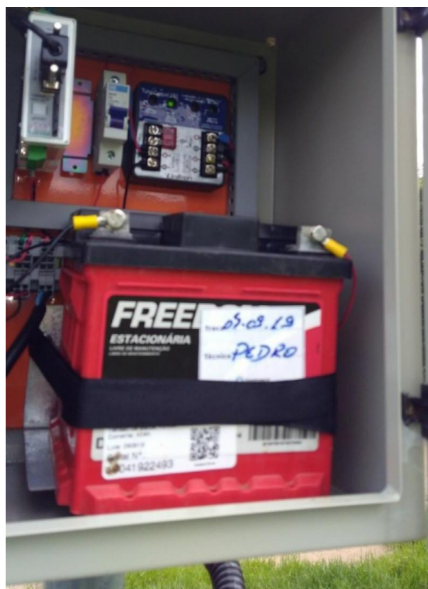
Foto 10 - Estação Telemétrica Limpa (perto)
