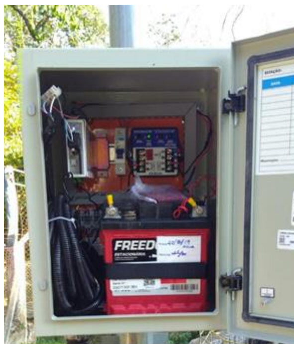
Foto 25 - Estação Telemétrica Limpa (perto)
