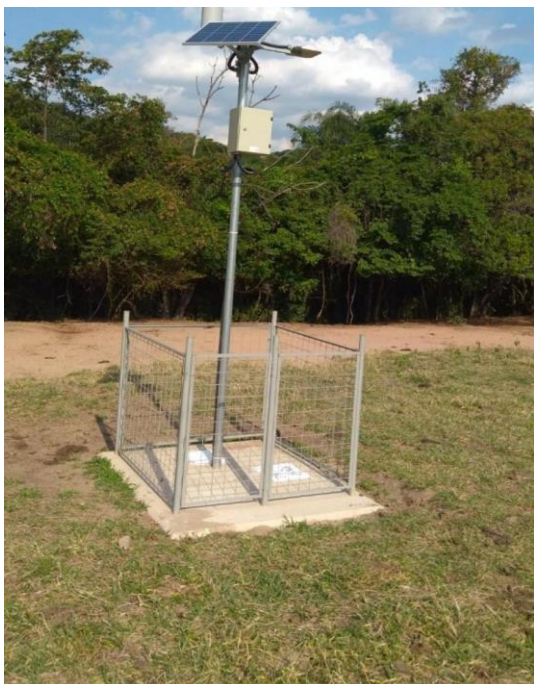
Foto 7 - Estação telemétrica Limpa (longe)
