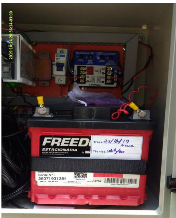
Foto 34 - Interior do Painel.
