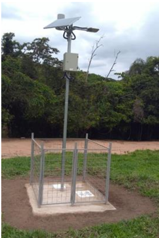
Foto 5 - Estação Telemétrica Limpa (longe).
