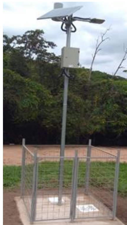
Foto 6 - Estação Telemétrica Limpa (perto)
