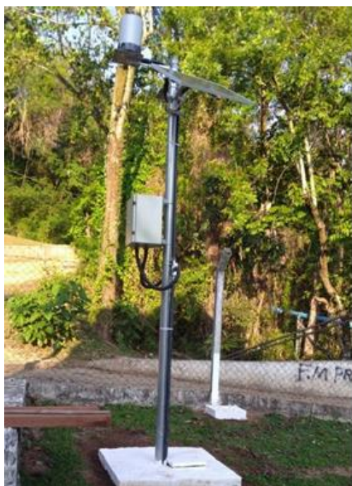
Foto 20 - Estação Telemétrica Limpa (longe).
