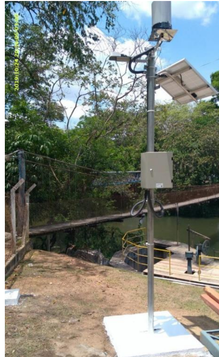
Foto 33 - Estação Telemétrica Limpa (perto)
