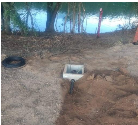
Foto 3 – Detalhe da caixa de cabos da sonda (05/09/19).
