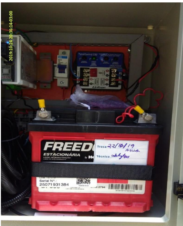
Foto 34 - Interior do Painel.
