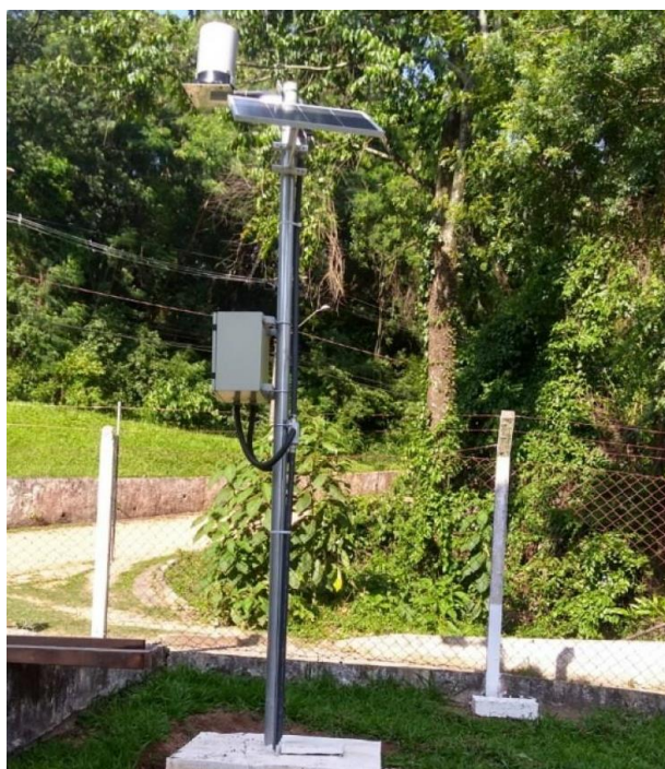
Foto 20 - Estação Telemétrica Limpa (longe).
