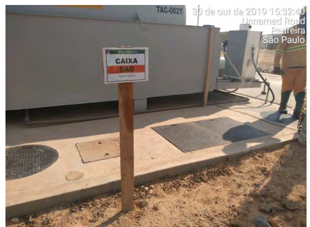
Foto 240 —Caixa SÃO instalada no posto de abastecimento no canteiro operacional (Data:30/10/19)
