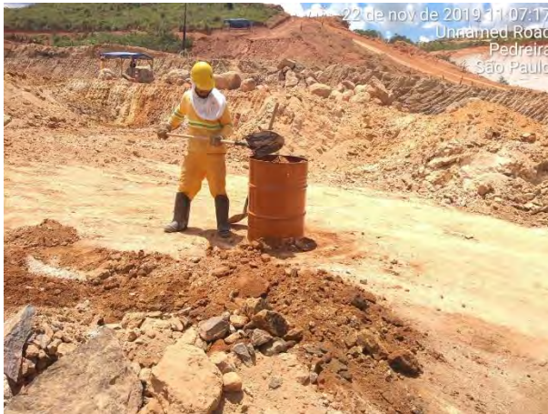
Foto 45 —Registro da remoção de solo com diesel proveniente de vazamento de equipamento. (Data:22/11/19)
