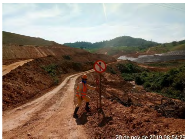
Foto 160 –Sinalização de direção proibida na via interna na margem esquerda. (Data: 20/11/19)
