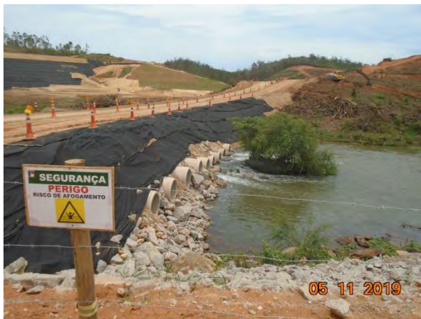
Foto 145 –Sinalização de segurança na passagem molhada. (Data: 05/11/19)
