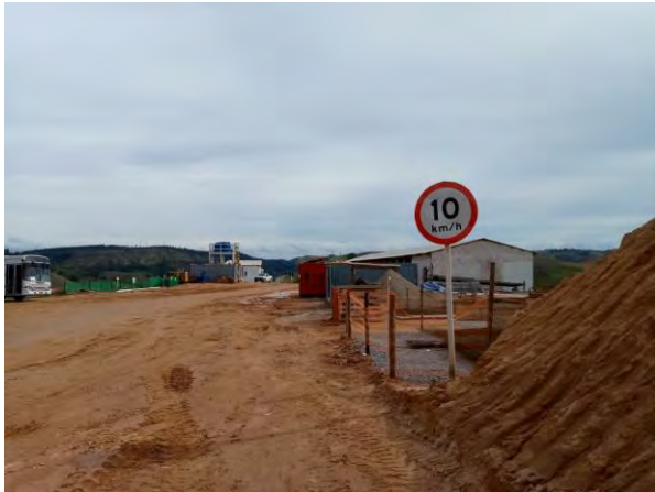
Foto 153 –Sinalização de velocidade máxima permitida na área do canteiro operacional. (Data:04/10/19)
