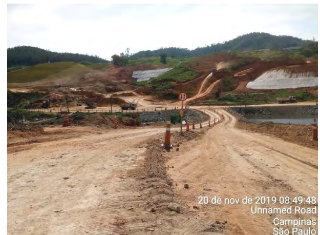
Foto 158 –Sinalização de direções das vias internas da passagem molhada. (Data:20/11/19)
