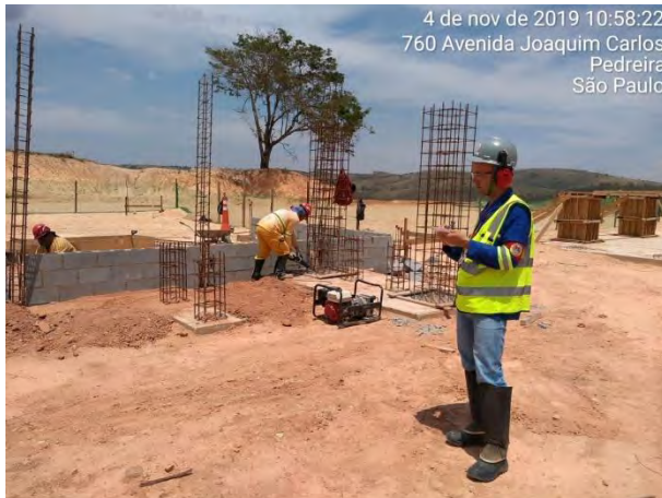
Foto 89—Profissional de segurança do trabalho observando e anotando os desvios encontrados. (Data:04/11/2019)
