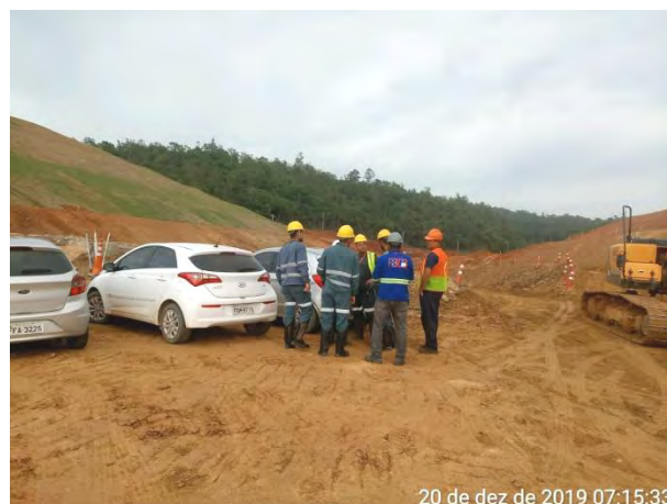
Foto 130 –Treinamento da APR de detonação com equipe de desmonte de rocha. (Data:20/12/19)
