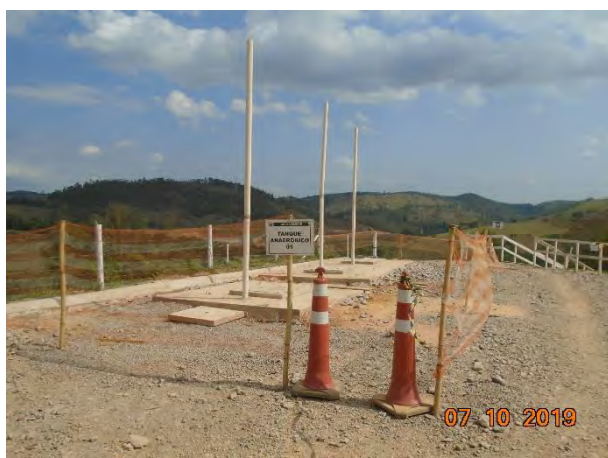
Foto 257 —Sistema de tratamento anaeróbico no canteiro operacional. (Data: 07/10/19)
