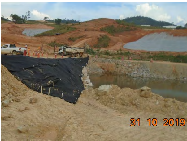
Foto 223 –Talude protegido com manta geotêxtil, após formação de erosão. (Data:31/10/2019)
