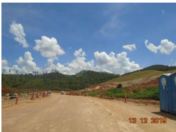
Foto 149 –Sinalização com cones na via externa. (Data:13/12/19)
