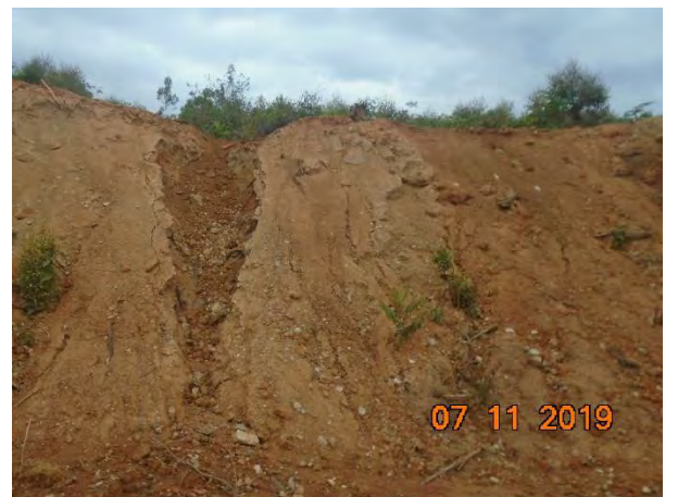
Foto 224 –Talude de acesso para bota-fora II M.E. com erosão após chuva. (Data:07/11/19)
