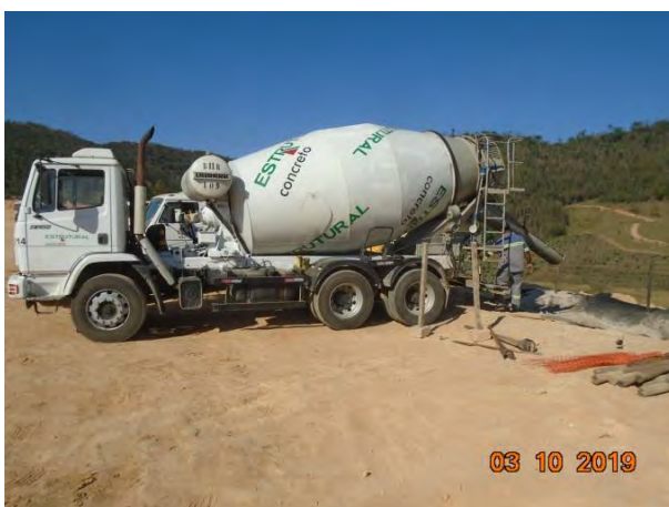
Foto 239 —Registro de lavagem de betoneira no canteiro operacional (Data:03/10/19)
