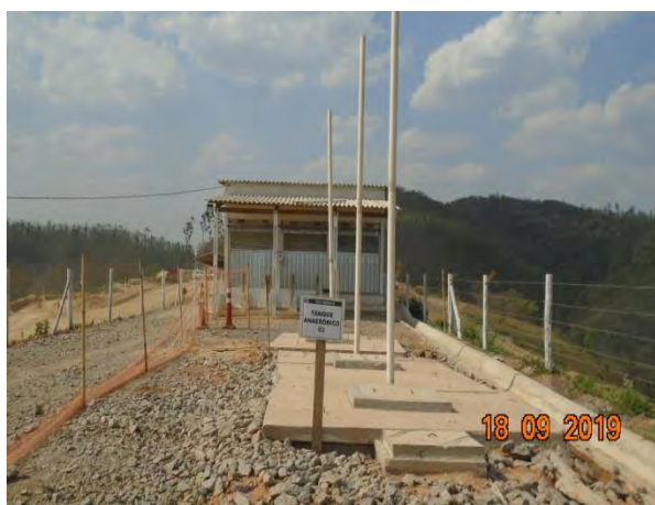
Foto 255 —Área dos tanques anaeróbico no canteiro operacional.
