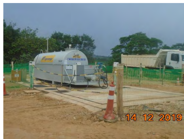
Foto 38 –Posto de abastecimento no canteiro operacional. (Data:14/12/19)
