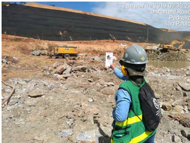
Foto 275 —Registro de fumaça preta em gerador (Data:12/11/19)
