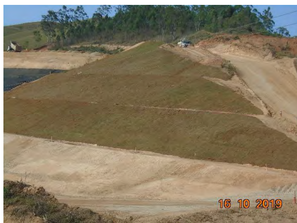
Foto 179 –Talude gramado com bermas na margem esquerda, no desvio do rio. (Data:16/10/19)
