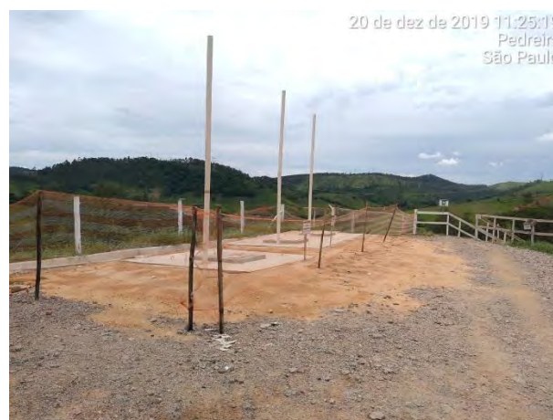
Foto 260 —Sistema de tratamento anaeróbico do efluente doméstico no canteiro operacional. (Data:20/12/19)
