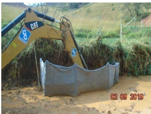
Foto 203 —Registro de limpeza de cacimba após chuva, próximo ao bota-fora IV. (Data:02/09/19)
