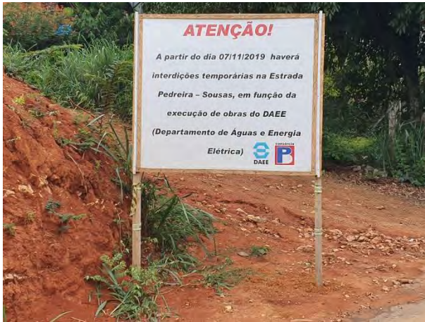
Foto 107 –Sinalização na estrada municipal de Pedreira sobre a atividade de desmonte de rocha. (Data:20/12/19)
