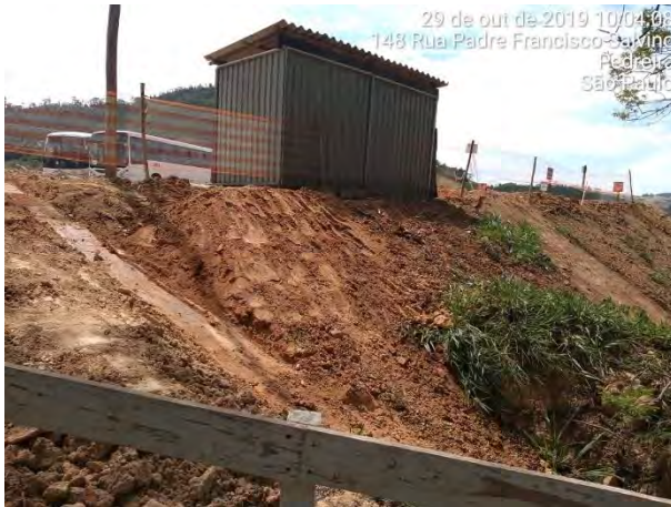
Foto 221 –Talude conformado, após formação de erosão. (Data:29/10/19)
