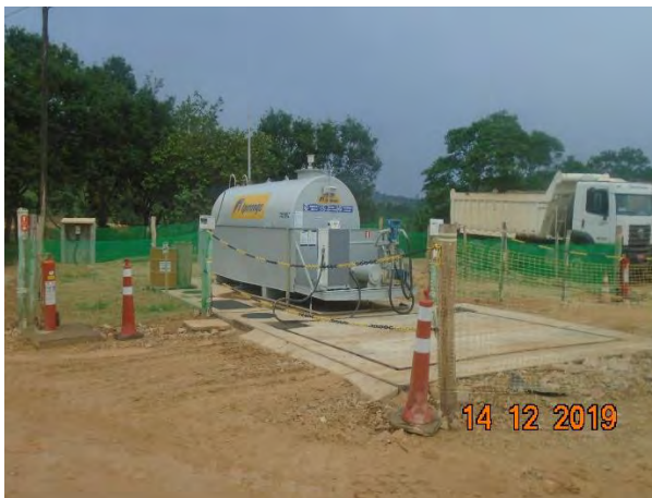
Foto 47 —Kit de emergência ambiental disponível na frente de abastecimento. (Data:14/12/19)
