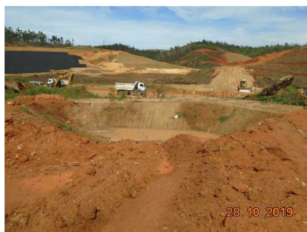
Foto 220 –Cacimba contendo material carreado com a chuva margem esquerda. (Data:28/10/19)
