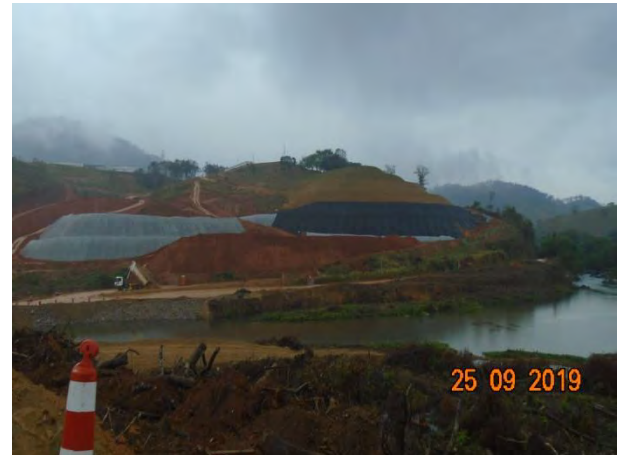
Foto 210 —Inspeção em dia de chuva nos bota-espera margem direita, cobertos por manta geotêxtil. (Data:25/09/19)
