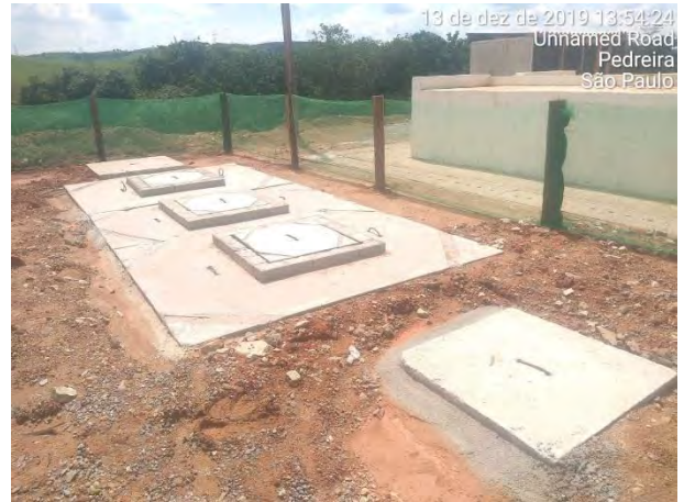
Foto 244 –Caixa SAO instalada no pátio de manutenção. (Data:13/12/2019)
