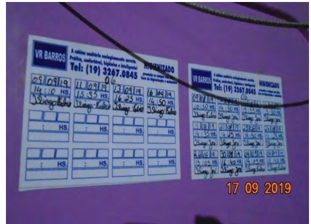
Foto 246 –Ficha de higienização de banheiro químico feminino instalado no canteiro operacional. (Data:17/09/19)
