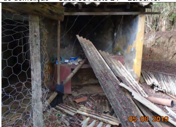
Foto 16 – Detalhe das telhas de amianto antes da demolição – Casa 21 / Lote 4 – 05/08/19.
