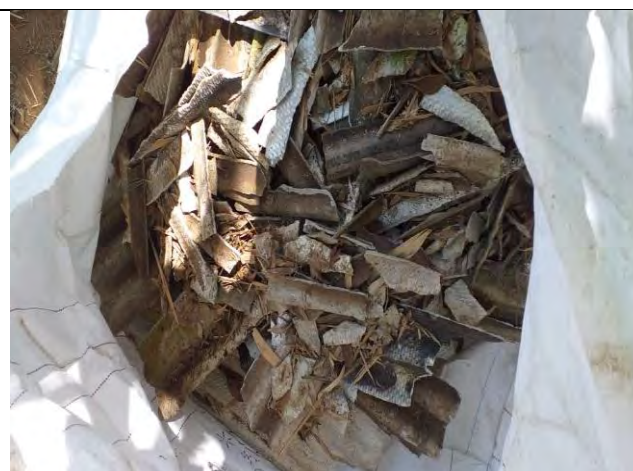
Foto 6 - Segregação de material perigoso (telhas de amianto), Casa 64 e 65 / Lote 2 - 30/05/2019.
