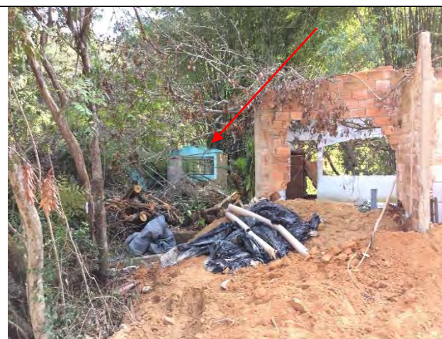
Foto 3 - Vista geral do imóvel antes da demolição, indicada pela seta vermelha – Casa 65 / Lote 2 – 29/05/2019.
