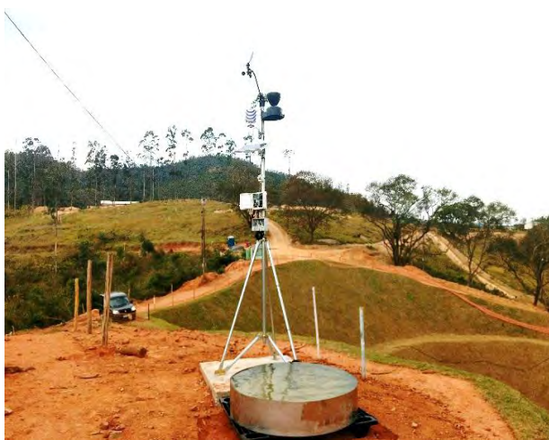
Foto 1 – Vista geral da EMA. Foto tirada no dia da instalação – 06/09/2019.
