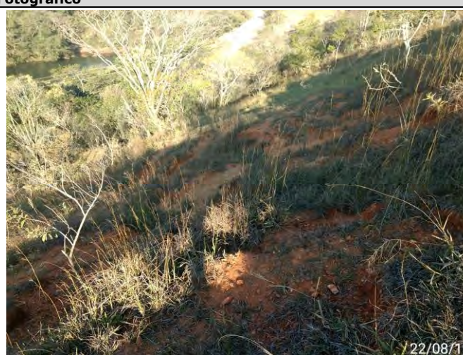
Foto 02: Detalhe do processo erosivo.
