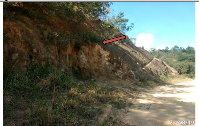
Foto 02: Ausência de cobertura vegetal do talude.
