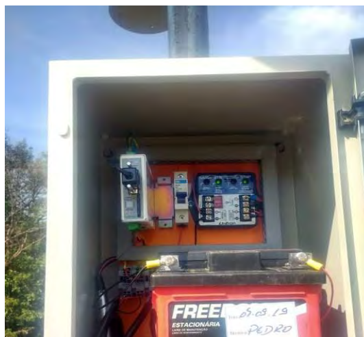
Foto 4 – Detalhe do painel da estação de telemetria (05/09/19).
