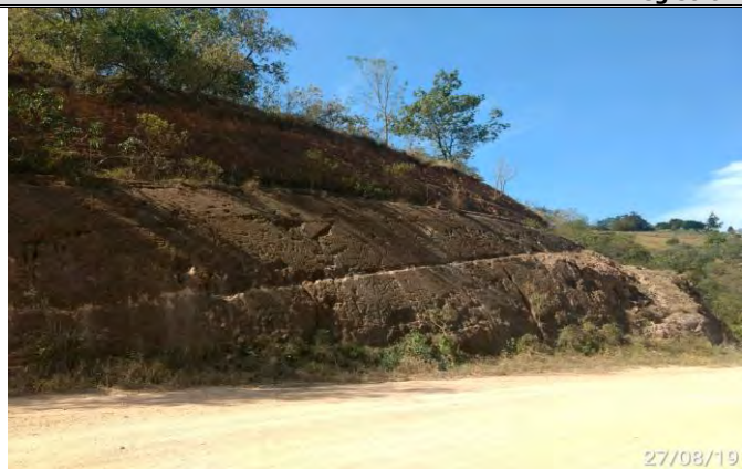
Foto 01: Risco de deslocamento do maciço rochoso.
