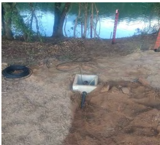
Foto 3 – Detalhe da caixa de cabos da sonda (05/09/19).
