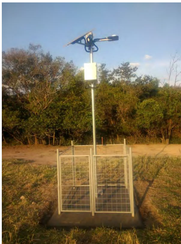
Estação Telemétrica Limpa (perto)
