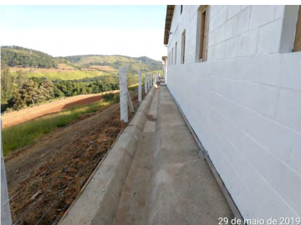
Foto 121 - Canaleta de concreto compondo o sistema de drenagem definitiva de água pluvial no canteiro operacional.
