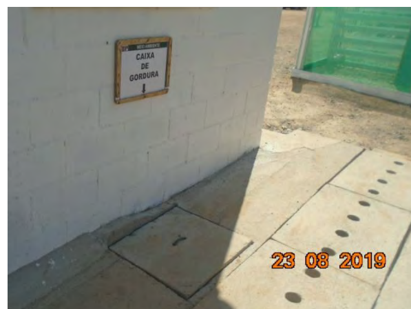
Foto 150 – Identificação da caixa de gordura instala no refeitório do canteiro operacional.
