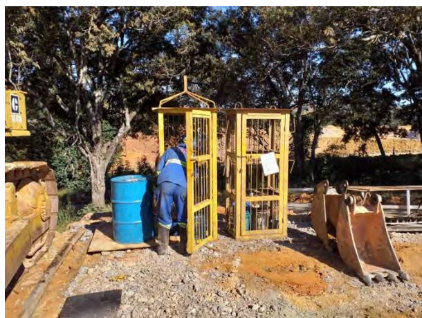
Foto 19 – Registro de colaborador adequando a frente de serviço, armazenando os produtos químicos em baía provisória. (Foto: 11.07.2019).
