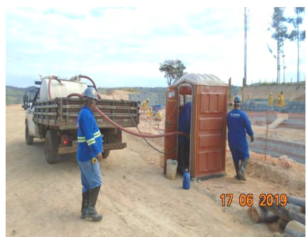
Foto 146 - Registro de retirada de efluente sanitário das frentes de serviço
