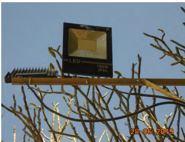
Foto 47- Iluminação com lâmpadas de LED.
