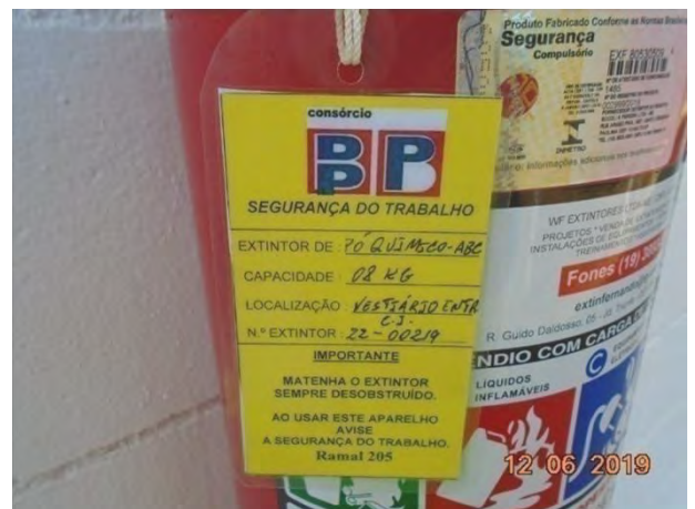
Foto 59- Extintor com etiqueta de inspeção.
