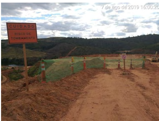
Foto 113 – Isolamento com sinalização de sentido proibido, com risco de tombamento dentro da obra.
