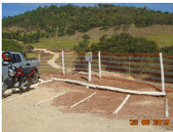
Foto 49- Reutilização de madeiras (exóticas - Eucaliptos) delimitação de vagas e fixação de cerquite para sinalização no estacionamento.
