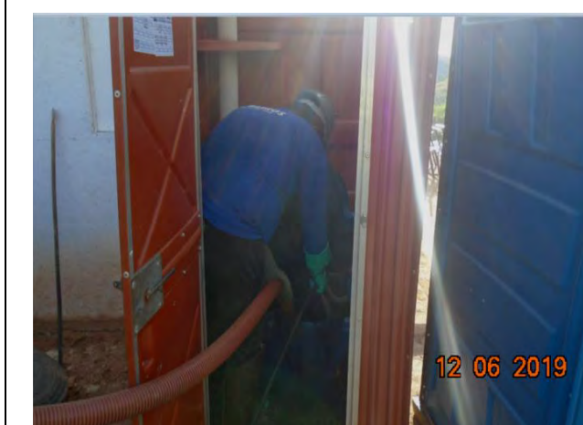
Foto 145 - Registro de retirada de efluente sanitário das frentes de serviço
