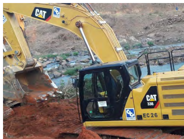
Foto 63 – Equipamento atuando com o selo de inspeção de agosto - verde. (Foto: 30.08.2019)
