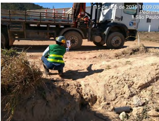
Foto 169 - Monitoramento de fumaça preta em equipamento do empreendimento.
