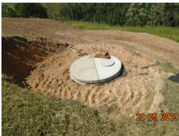
Foto 157 - Sumidouro instalado no canteiro operacional.
