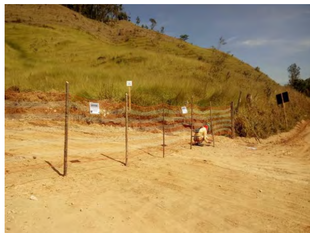
Foto 97 - Isolamento para acesso restrito. (Foto:18/06/2018)
