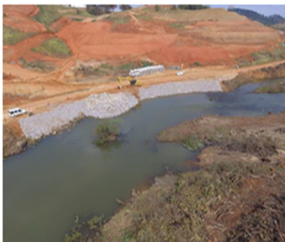
Foto 24-31/08/2019-Proteção de talude com enrocamento - Passagem Molhada – MD – 1ª Etapa da Ensecadeira M01
