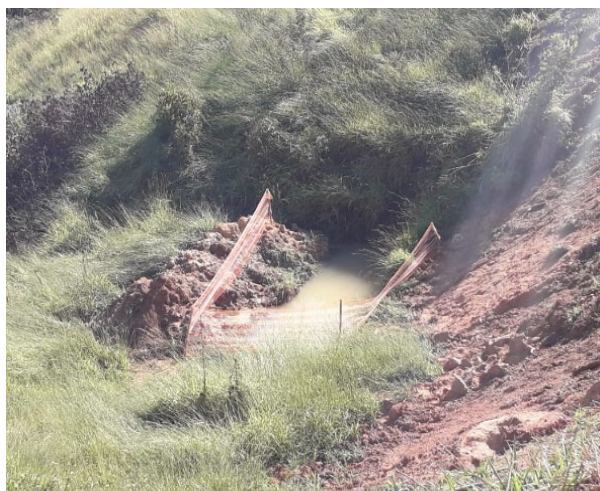
Foto 15- 28/05/2019 – Sistema de drenagem- Cacimba
