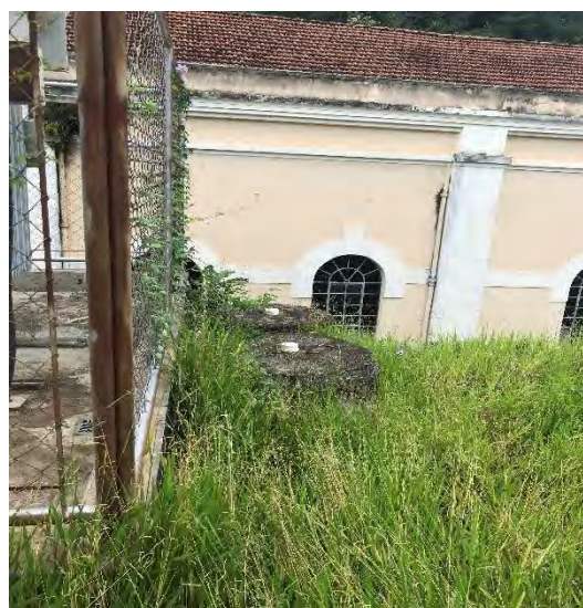
Figura 11.5-15: Caixas coletoras ao lado dos transformadores.
