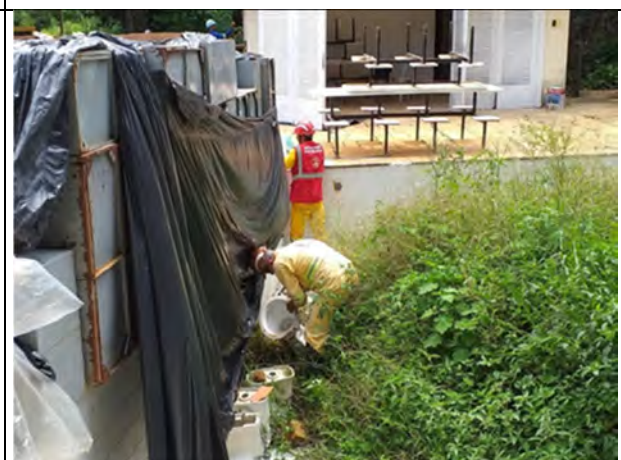
Foto 21 – Monitoramento de água parada no canteiro de obras – 08/03/19.
