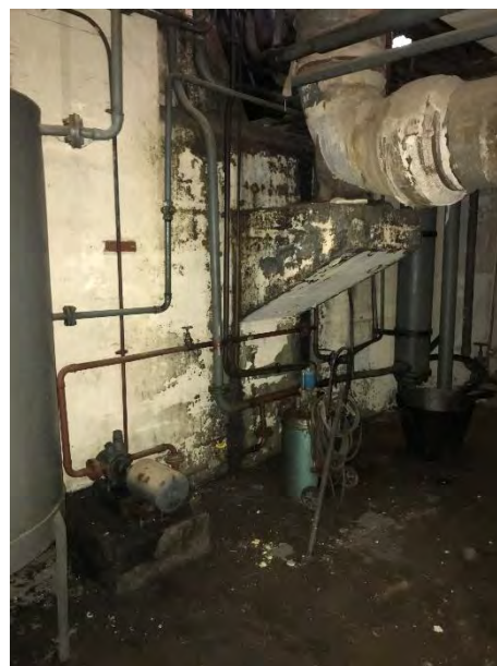
Figura 11.5-9: Encanamentos aéreos utilizados para conduzir o óleo para filtragem, na parte inferior do local.
