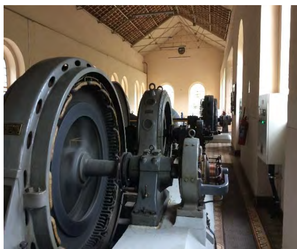
Figura 11.5-10: Motores de geração ativos.
