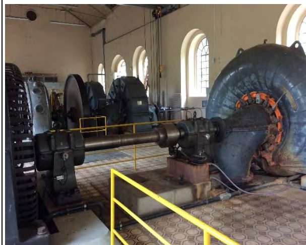
Figura 11.5-11: Motores de geração ativos.
