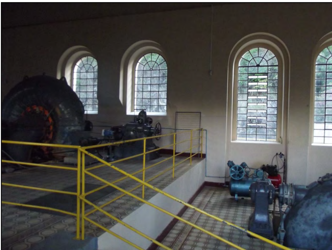
Figura 94: Sala de maquinas - Macaco Branco
