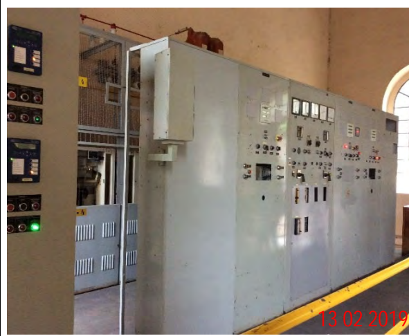
Foto 21: Painel de controle.
