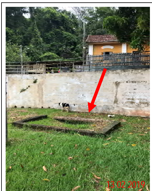
Foto 9: Fossa séptica, seta indicando o local de afundamento de solo.
