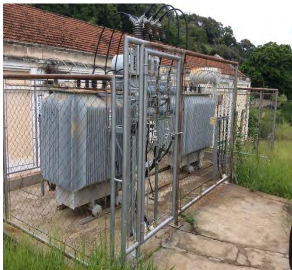
Figura 11.5-14: Transformadores instalados na AS01.
