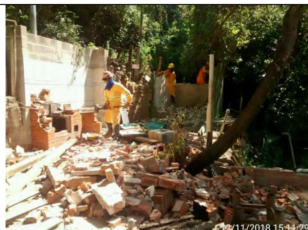
Foto 14- Laudo 01 Área desapropriada – Clube dos Moicanos – 12/11/2018
