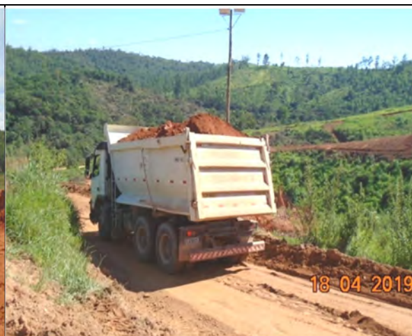
Foto 178 - Movimentação de solo da escavação obrigatória da margem direita para bota espera margem direita.
