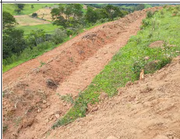
Foto 102 - Implantação de sistema de drenagem provisória, através de canaletas de solo para o disciplinamento das águas pluviais. (Foto:06.02.2019).
