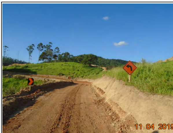
Foto 81 – Sinalização de vire à esquerda sentido escavação obrigatória. (Foto: 25.04.2019)
