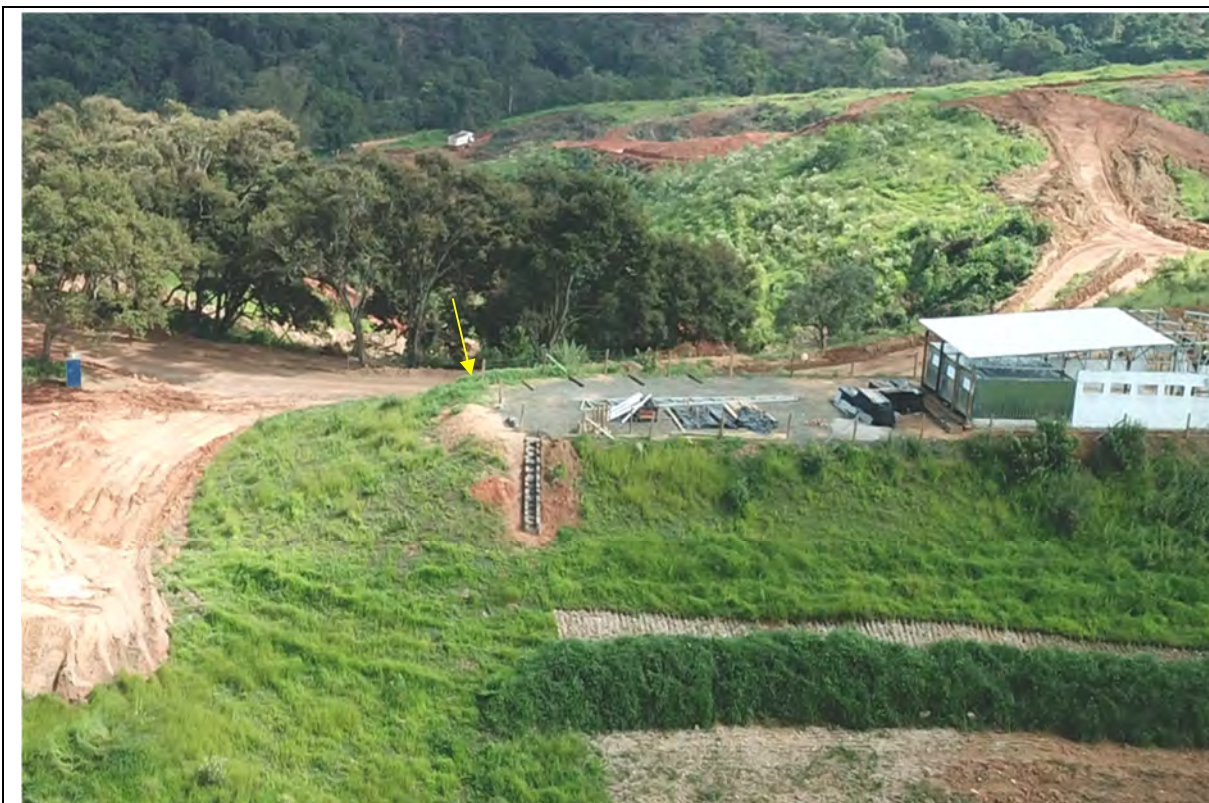
Foto 136 - Imagem aérea evidenciando local de implantação do sistema de tratamento de efluente no canteiro industrial. (Foto:17.04.2019)
