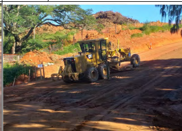
Foto 110 - Eliminação de áreas fontes de sedimento. (Foto: 30.04.2019)
