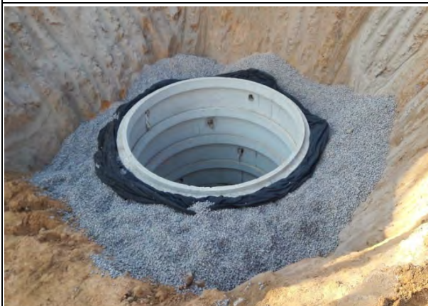
Foto 137 - Registro de instalação do sumidouro no canteiro industrial. (Foto: 23.04.2019)
