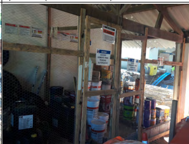
Foto 20 – Baía de produtos químicos instalada no canteiro administrativo (Foto: 30/04/2019)
