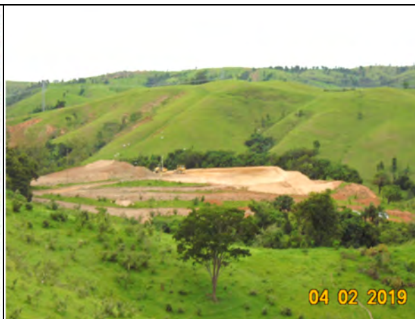
Foto 100 - Curva de nível na área do aterro para implantação do canteiro industrial.
