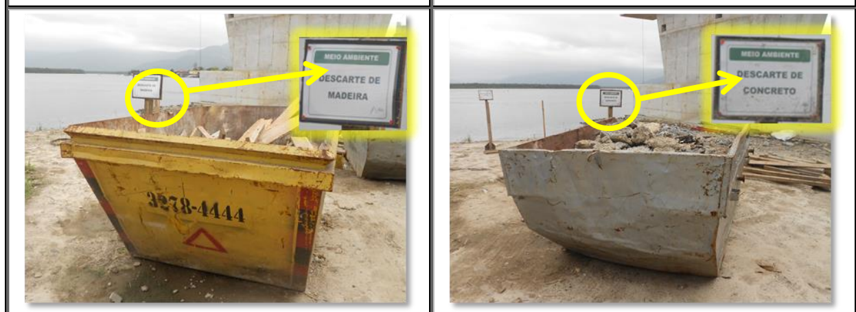
Fotos 5.2-13 e 5.2-16: Exemplos de identificações e local (recipientes e caçambas) adequados ao acondicionamento de resíduos gerados nas frentes de obra.
