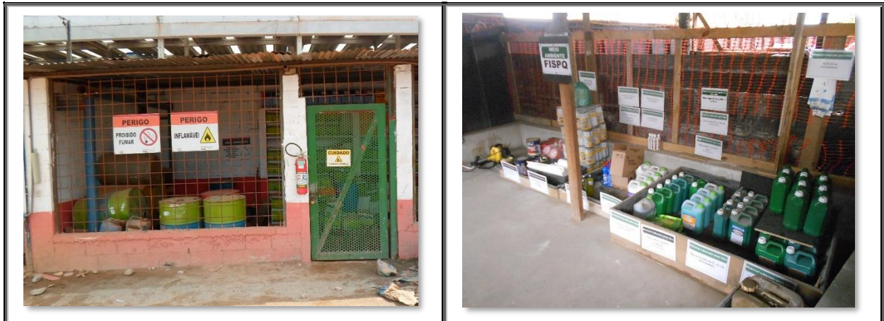
Fotos 7.1.3-11 e 7.1.3-12: Exemplo de locais de acondicionamento de produtos combustíveis, reagentes e produtos químicos dotados de cobertura, piso impermeável, ventilação, sinalização, controle de acesso
